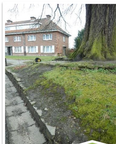
Ravinement dans les talus.
